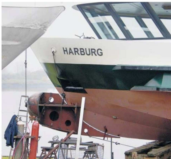
Die neue Nase: Der aus 51 Teilen bestehende Bugwulst wird auf der SSB-Werft in Hamburg-Ochsenwerder einfach an den bestehenden Rumpf einer Hafenfähre des Typs 2000 montiert.
